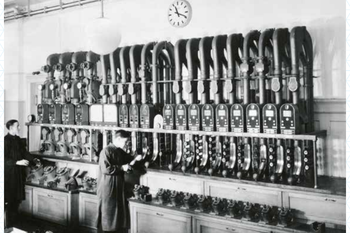
Stadtrohrpostzentrale im Haupttelegrafenamnt Fraumünster, 1950.
